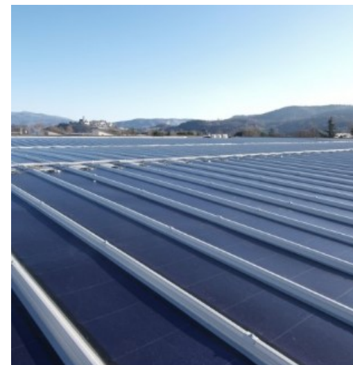
65 kWp Porrena (AR)
