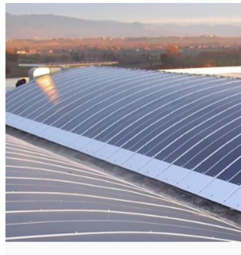
73 kWp Marciano della Chiana (AR)
